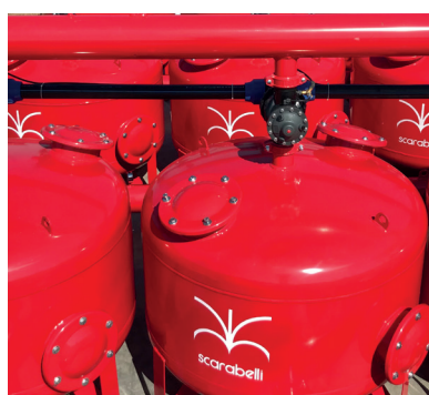
BATERIE DE FILTRARE DE PIETRIȘ
